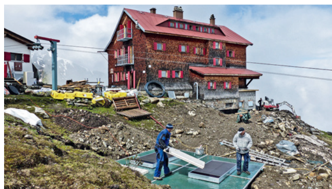
Sonnenstrom vom Dach für die Kaltenberghütte der Sektion Reutlingen im Verwall.
