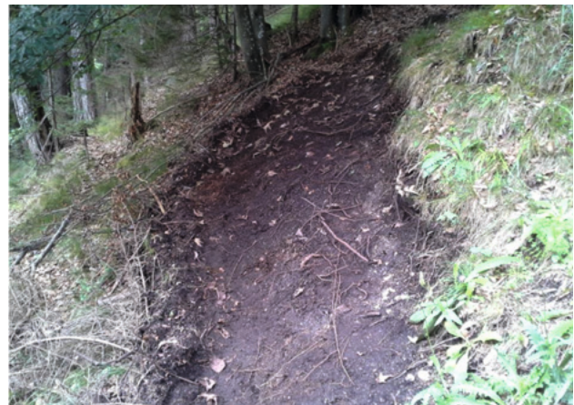
Abbildung 7: Wegkantenabbruch. (Bild: Amor)
