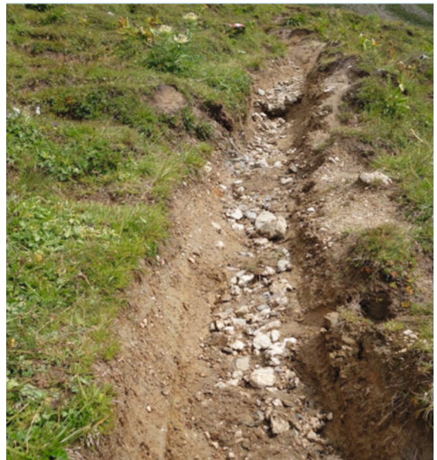
Abbildung 6: Erosionsrinne. (Bild: Derungs)
