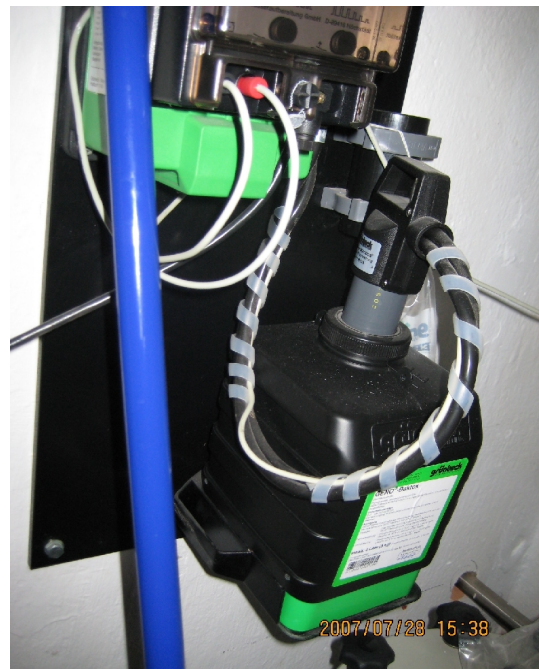
Abbildung 86: Wasseraufbereitung durch Chlorung auf der Nördlinger Hütte
