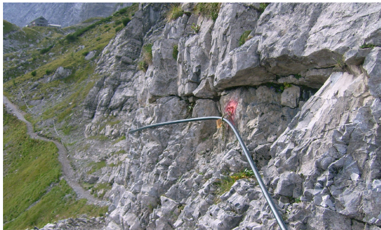
Abbildung 83: Wasserleitung (von Tiefbehälter) - Lamsenjochhütte
