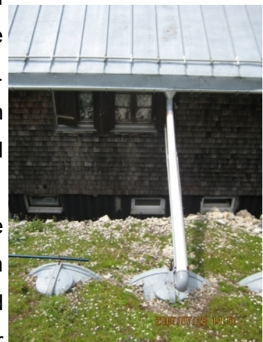
Abbildung 80: Dachwasserfassung Nördlinger Hütte
