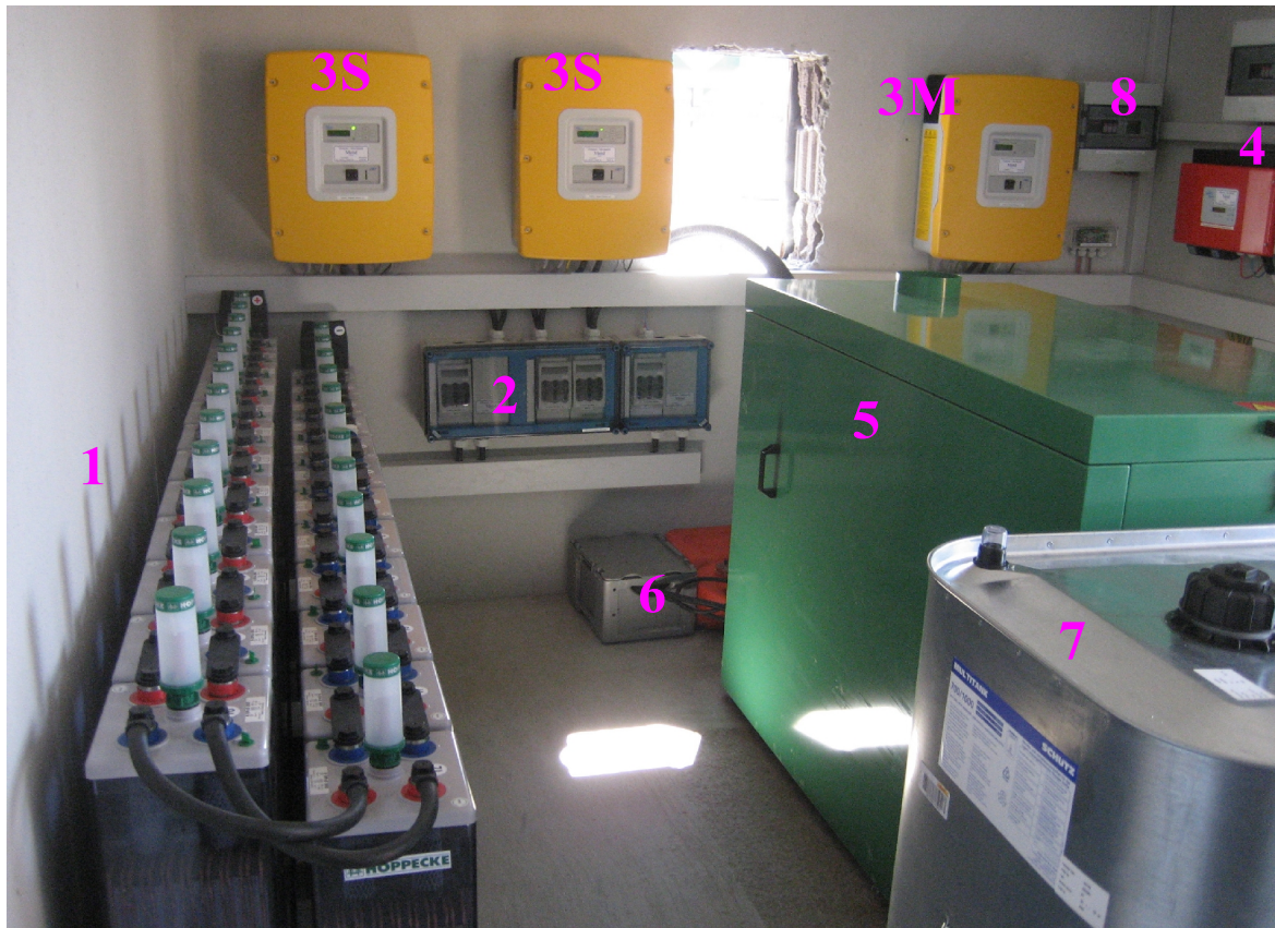
Abbildung 69: Typischer Aufbau einer dreiphasigen Hybridanlage in einer der 2008 modernisierten Hütten [H. Deubler]
