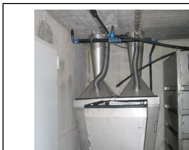
Abbildung 101: Trockentoilette (Fäkalbehälter und Abluft)
