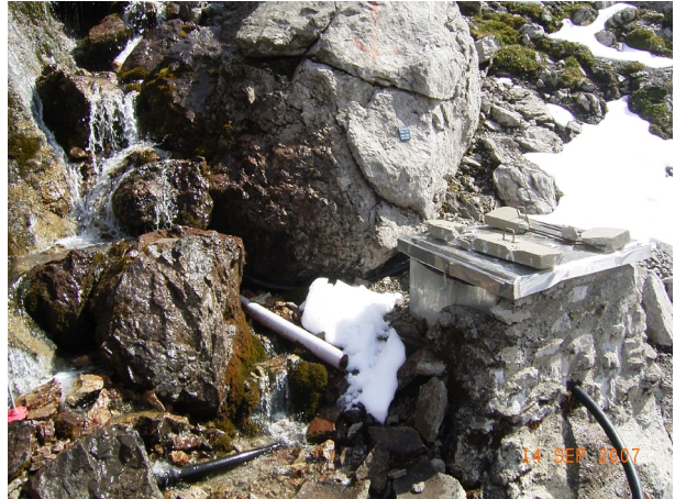
Abbildung 79: Oberflächenwassersammlung (Bach) Waltenberger Haus
