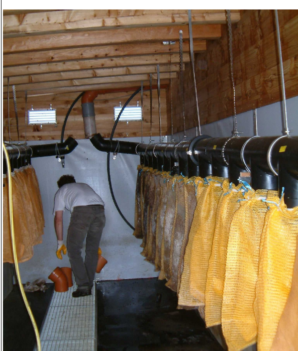
Abbildung 103: Filtersackanlage Bonn Matreier Hütte
